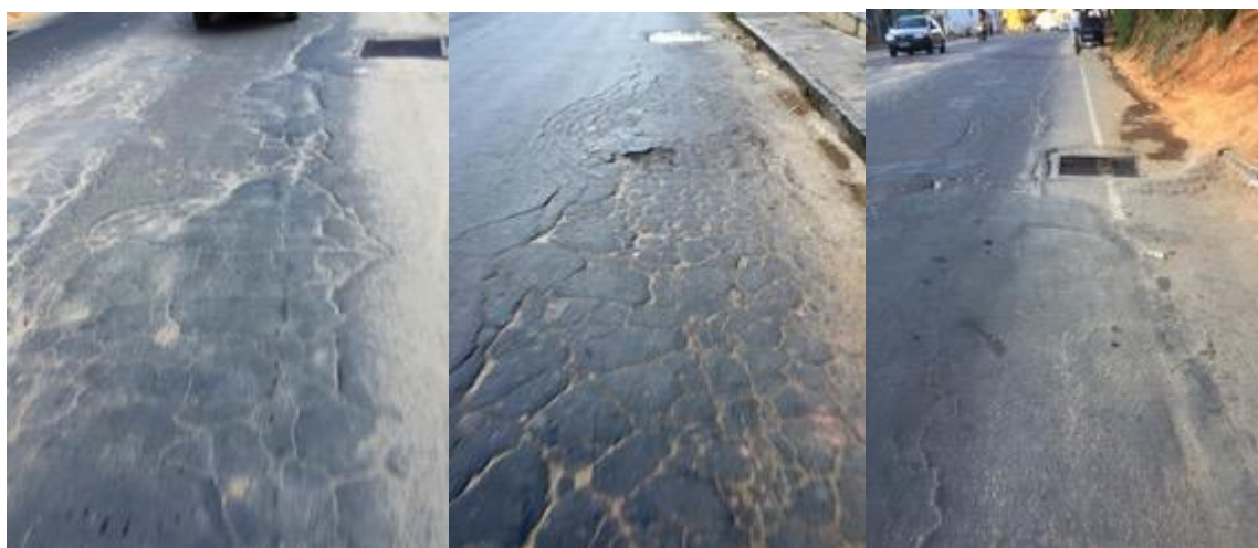
Fotografia 01 – Defeitos de superfície encontrados na avenida
