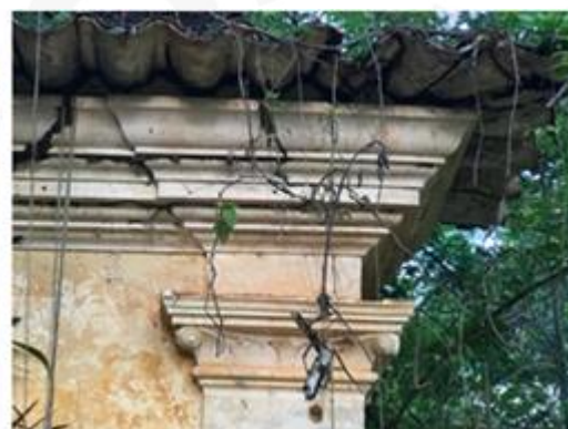
Figura 8: Vestígios do telhado
