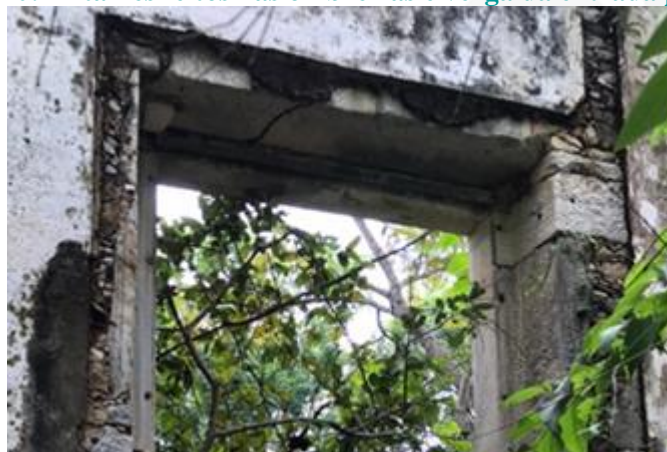
Figura 10: Entalhes feitos nas ombreiras e verga da entrada principal
