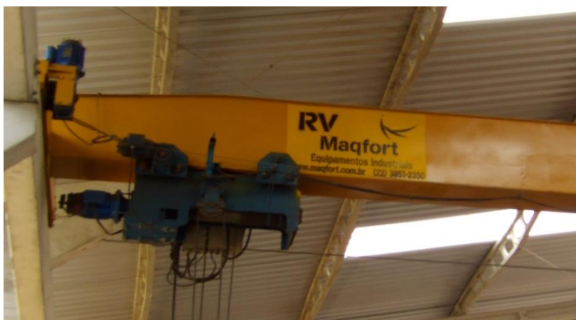
Figura 2: Talha Elétrica - Cabeceira - Lado Esquerdo do Galpão – Fonte: Autor
