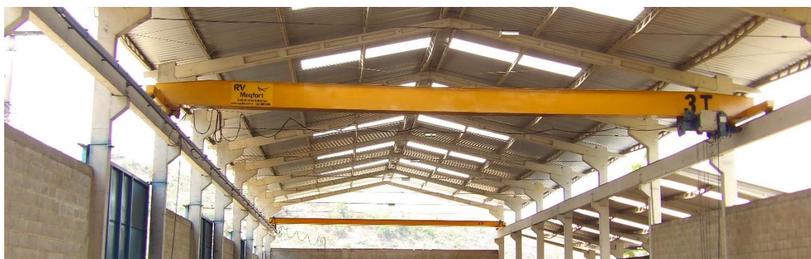
Figura 1: Ponte Rolante 3 ton. in loco - Fonte: Autor
