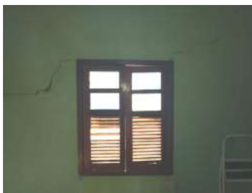
Figura 07 – Trinca atravessando a janela devido à ausência de verga e contraverga
