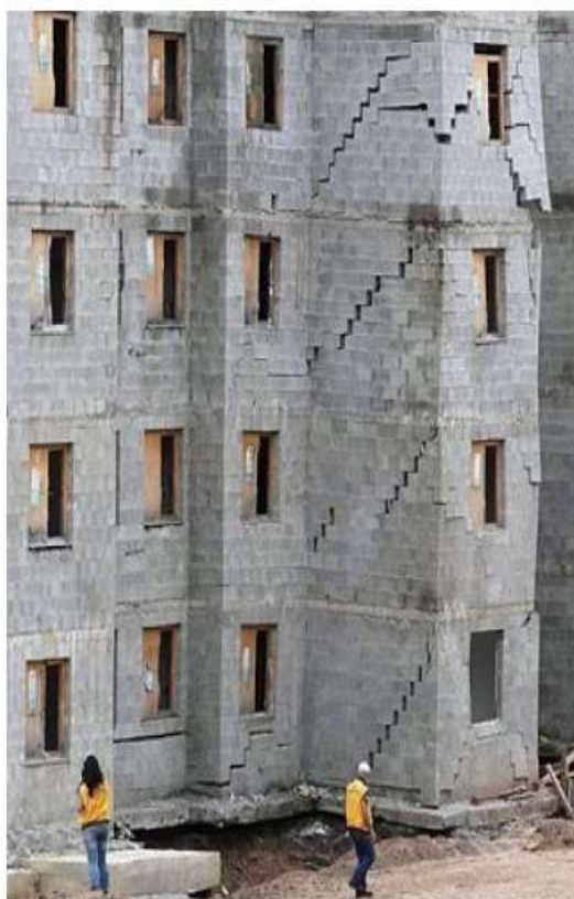
Figura 03 – Recalque diferencial na edificação Fonte: MAQUINADEAPROVAÇÃO, Online
