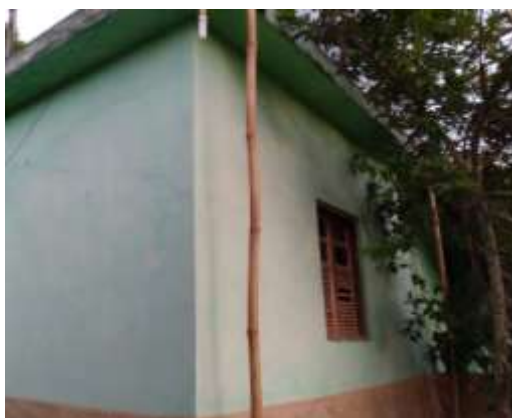
Figura 08 – Trinca do lado externo da edificação
