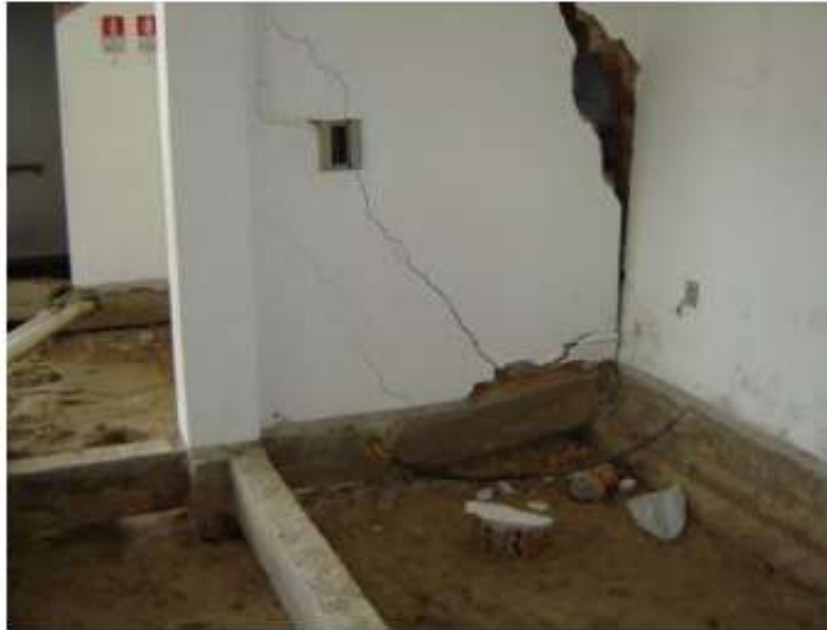
Figura 02 – Fundação má executada Fonte: Franco et al (2017)
