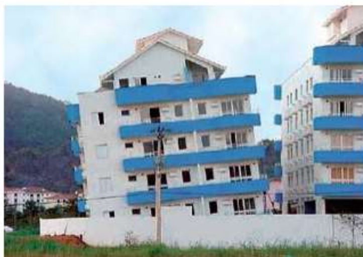
Figura 01 – Recalques e movimentos na estrutura
