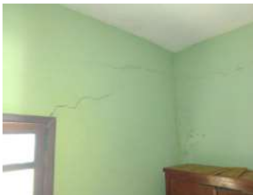
Figura 06 –Trinca na parede
