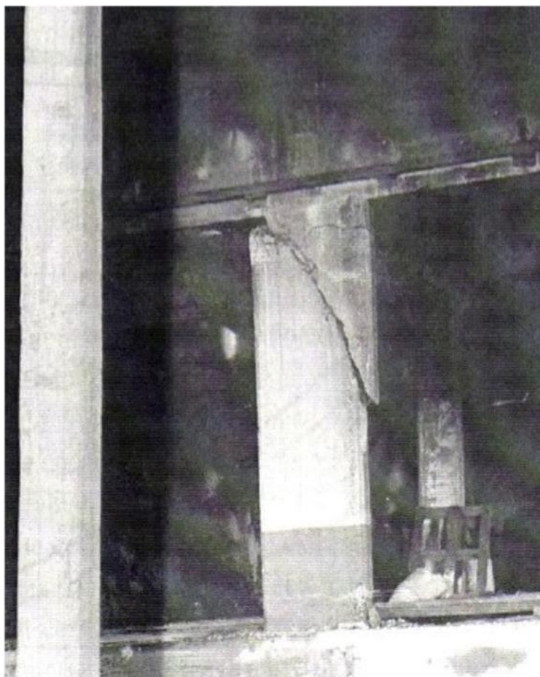
Figura 06 – Ruptura em pilar ocasionada pelo esforço cortante durante incêndio em um depósito na Bélgica, em 1974
